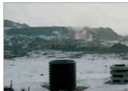
Slika 9. Sustav za otplinjavanje odlagališta “Totovec”
