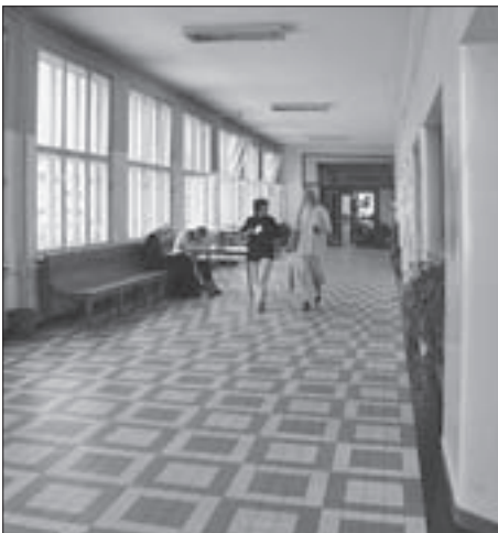
SL. 14. INTERIJER SREDIŠNJEGA DIJELA HODNIKA, FOTOGRAFIJA DANAŠNJEGA STANJA FIG. 14 CENTRAL SECTION OF A HALL, INTERIOR, PHOTO OF THE PRESENT STATE
