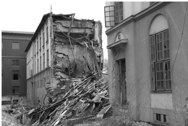
Slika 5. Urušeni središnji dio dvorišne zgrade (dugačke oko 50 m i široke manje od 5 m) nekadašnje tvornice Penkala-Moster d.d. Zgrada crvene fasade na koju se naslanja ta urušena zgrada ima pročelje na Branimirovu ulicu (v. sl. 4). To se dogodilo 1. listopada 2007. godine, tijekom kopanja jame za podzemnu garažu Poslovnog centra Krešimir. (izvor: internet)
