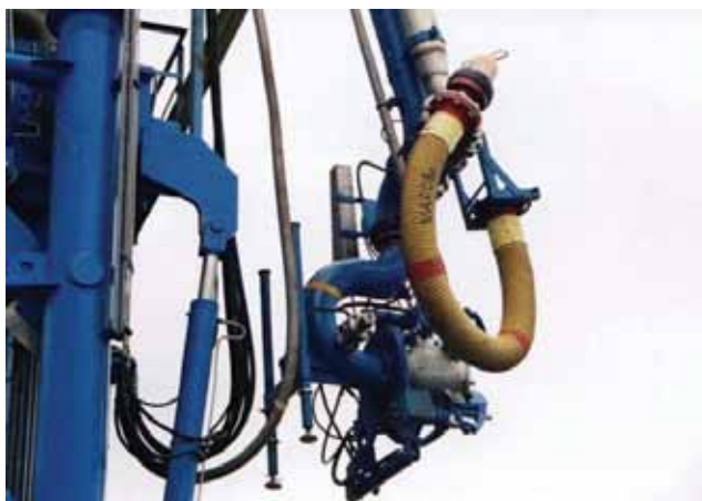
Slika 5. Ukrcajna rampa s linijom za povrat para s tankera
