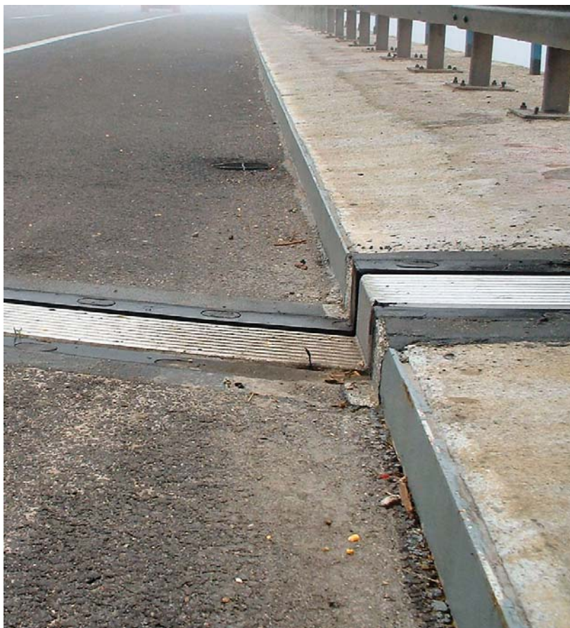
Slika 5: Detalj novog rubnjaka i prijelazne naprave
