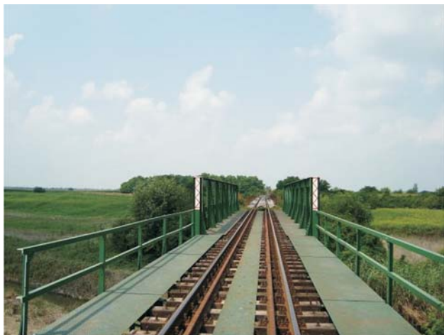
Figure 7 The renewed steel bridge at km 9+411,9 (near train stop Gaboš) Slika 7. Obnovljeni čelični most u km 9+411,9 (kod stajališta Gaboš)
