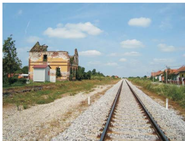
Figure 9 Heavy damaged construction of the train stop in Laslovo/Korođ Slika 9. Teško oštećena zgrada stajališta Laslovo/Korođ
