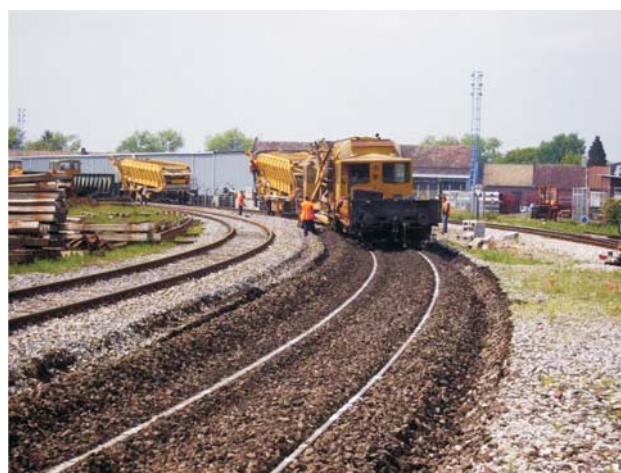
Figure 3 Ballast bed cleaning from station Vinkovci toward Osijek Slika 3. Strojno rešetanje kolosijeka od kolodvora Vinkovci prema Osijeku
