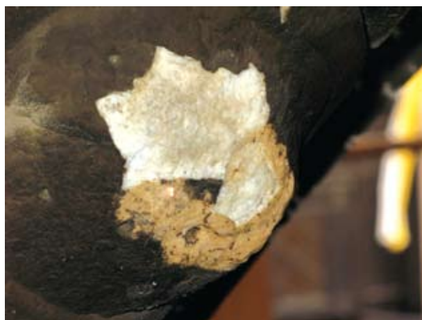
Pokus čišćenja laserom u području oštećene zone
