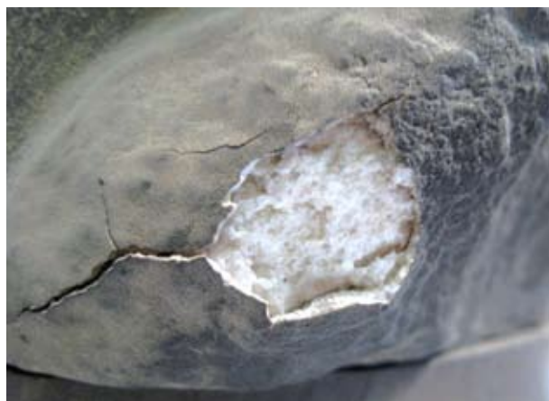
Oštećena zona kamena
