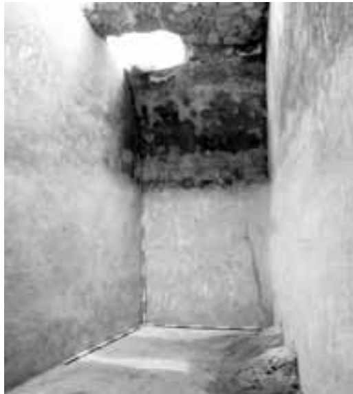
slika 12. Velika vodosprema, unutrašnjost filter komore s dijelom urušenog svoda (foto: Z. Sunko)
