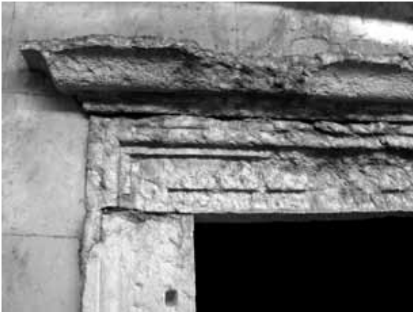
slika 7. Detalj kamene plastike, zatečeno stanje
