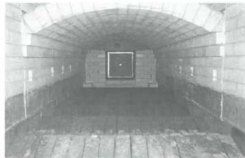
Slika 3. Unutrašnjost ložišta s vodoravnom rešetkom s koso položenim člancima
